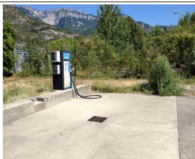
Poste de distribution des chargeurs
