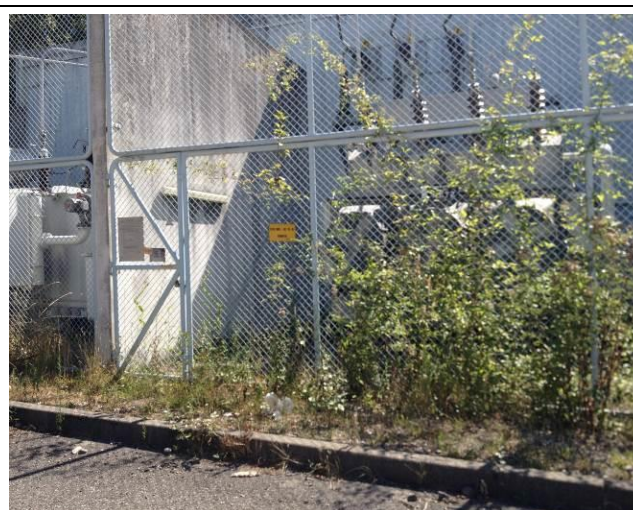
Postes de transformation
