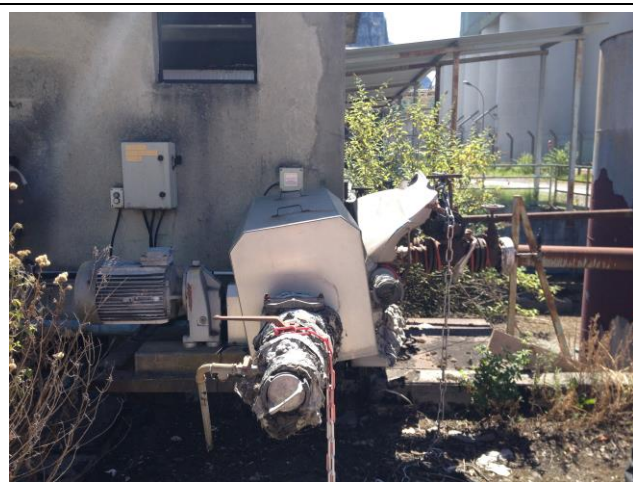
Zone de dépotage proche du parc à fioul
